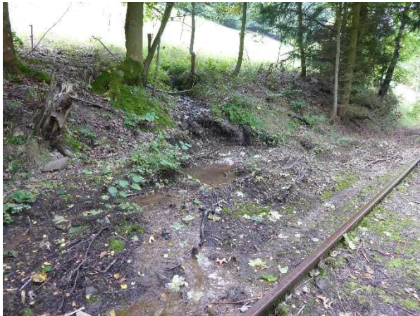
Abbildung 30 zugespülter Bahngraben, fehlender Durchlass km 7,9
