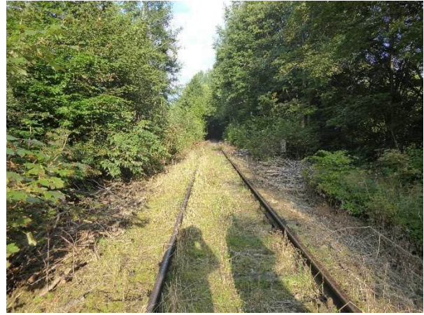
Abbildung 60 Schotterbett verunkrautet, km 3,6
