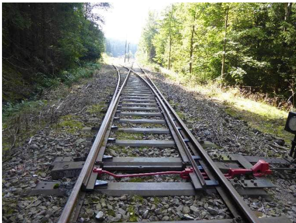
Abbildung 67 auf Ortbedienung umgebaute Weiche in Bf Lichte
