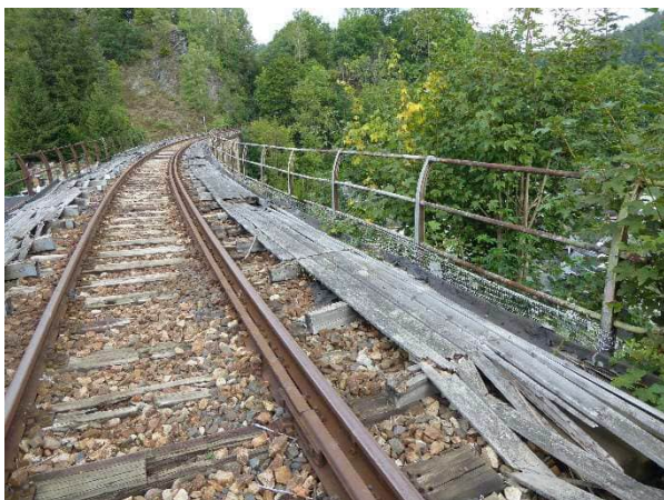
Abbildung 50 Holzschwellen, schlechter Zustand Viadukt Gräfenthal
