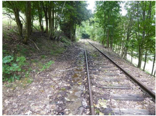
Abbildung 29 zugesetzter Bahngraben km 7,8
