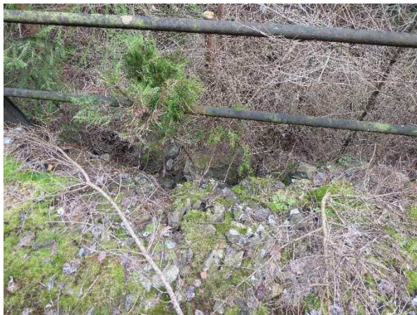
Abbildung 20 ausgebrochene Mauerkrone, abgerutschter Gleisschotter
