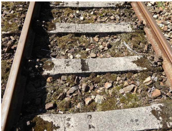
Abbildung 57 flach abgefahrne Bogeninnenschien (links), seitlich abgefahrener Schienenkopf an der Außenschiene (rechts), km 17,3
