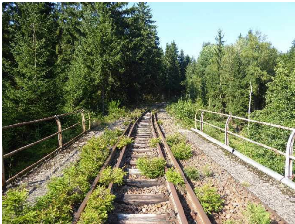
Abbildung 14 Bewuchs im Gleisbett der Brücke
