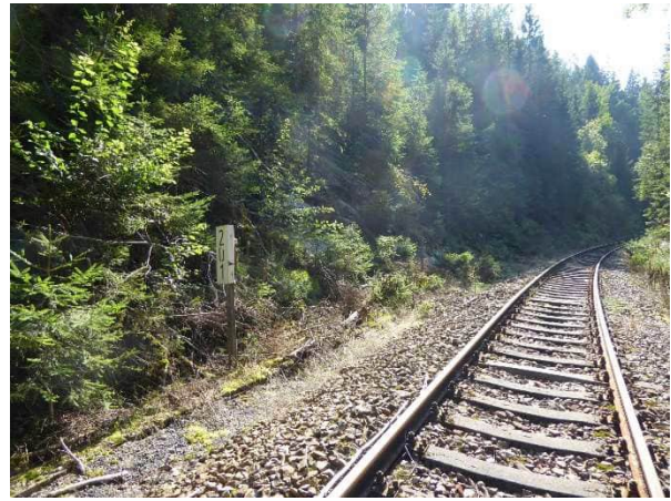
Abbildung 47 Betonschwellen, gerissen, km 20,1
