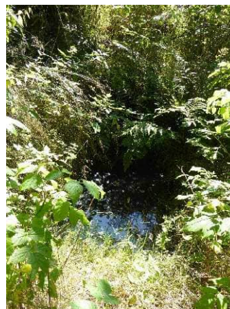
Abbildung 37 DL km 17,420 stehendes Wasser am Einlauf, DL spülen
