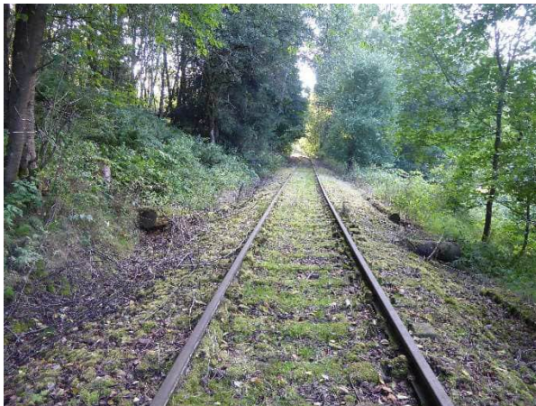
Abbildung 34 DL km 2,688, zu geringe Überdeckung
