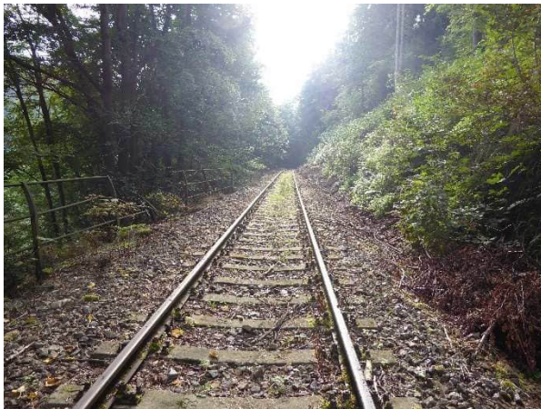
Abbildung 61 Schotterbett, mit Humus verschmutzt, km 4,6
