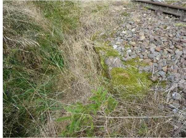
Abbildung 39 DL km 22,420, zu geringe Überdeckung, versandet, erneuern
