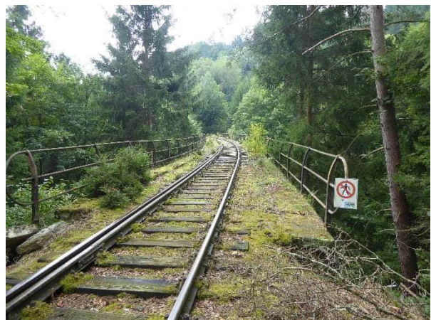
Abbildung 51 Holzschwellen, mäßiger Zustand, Viadukt Sommersdorf
