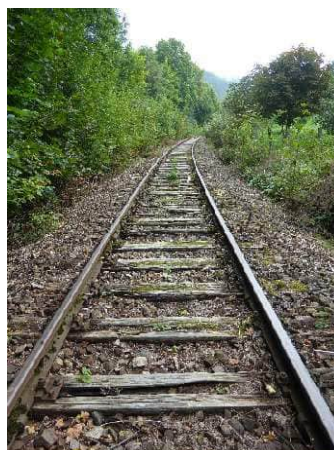
Abbildung 43 Holschwellen, schlechter Zustand, km 5,8
