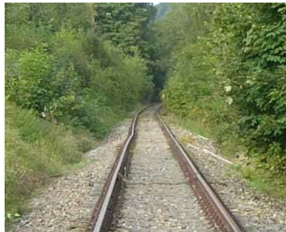
Abbildung 58 Gleislagefehler / Spurfehler, km 4,5
