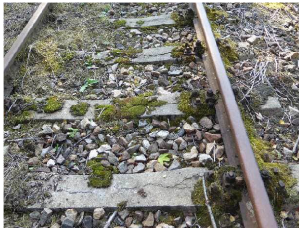
Abbildung 41 gerissene Betonschwellen km 2,1
