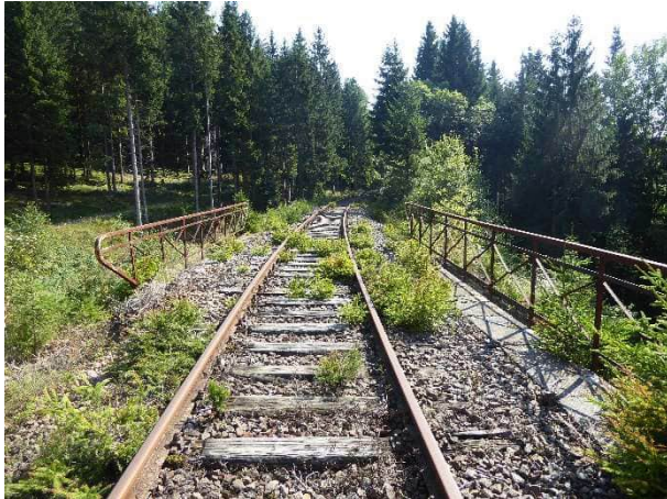
Abbildung 13 Bewuchs auf dem Bauwerk
