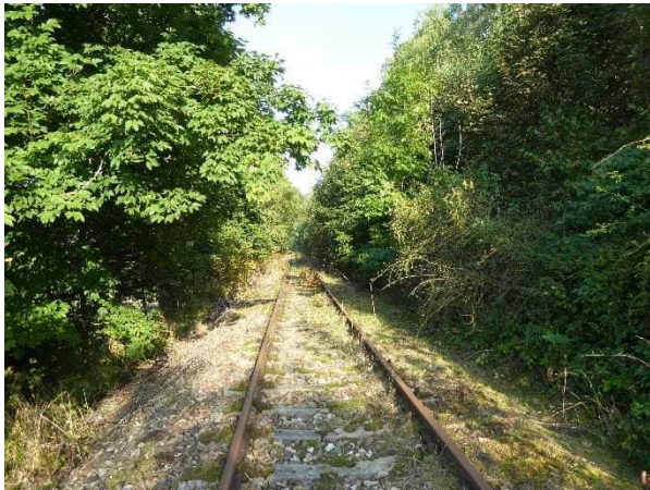
Abbildung 24 Bewuchs im und neben dem Gleis, km 2,1
