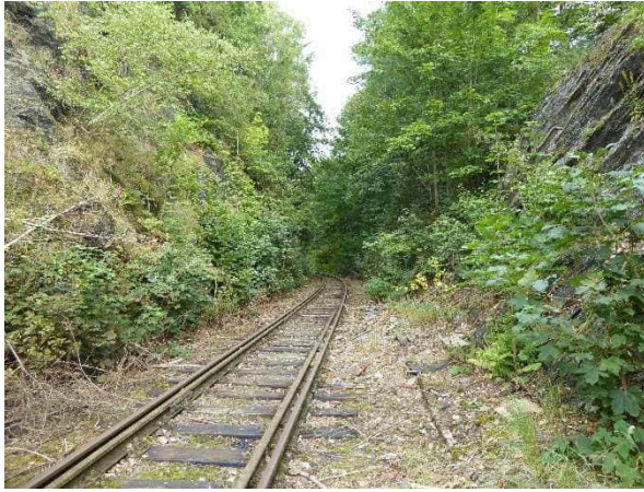
Abbildung 55 Holzschwellenoberbau mit Fahrschiene und Schutz- und Führungsschiene, km 6,3
