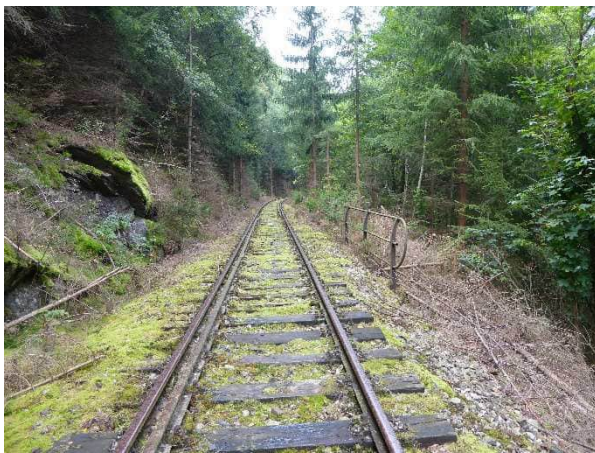
Abbildung 63 Schotter vermoost, fehlender Vorkopfschotter, km 7
