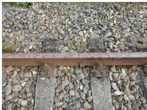
Abbildung 42 gerissene Betonschwellen km 4,6
