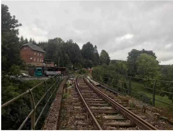
Abbildung 52 Holzschwellen, schlechter Zustand, Viadukt Lippelsdorf
