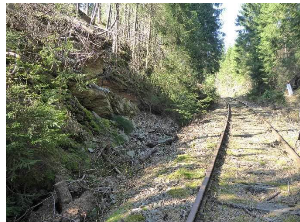
Abbildung 33 zugesetzter Bahngraben, km 21
