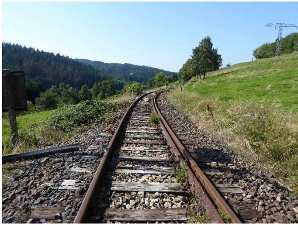
Abbildung 46 Holzschwellen, wechselnde Erhaltungszustände, km 15,8
