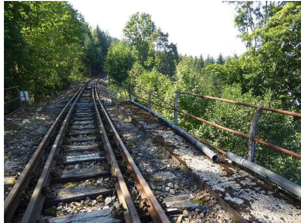
Abbildung 9 zerbrochenes Gelände am Brückenende
