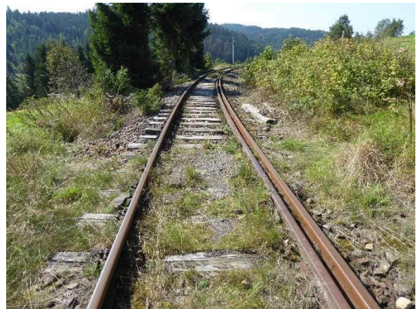
Abbildung 62 fehlender Vorkopfschotter, km 15,2
