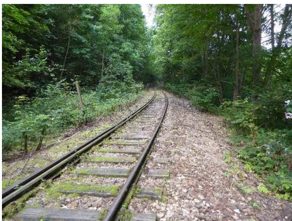
Abbildung 44 Holschwellen, verschiedene Erhaltungszustände (Regelfall) km 6,6
