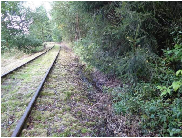
Abbildung 28 stehendes Wasser im bahngraben, km 2,7
