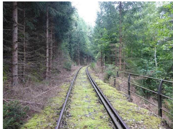
Abbildung 21 ausgebrochene Mauerkrone, gebrochener Geländerpfosten
