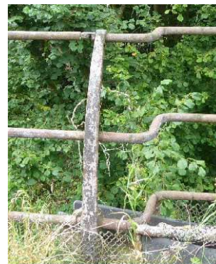
Abbildung 5 Flickstelle im Geländer, provisorisches Schotterfangnetz
