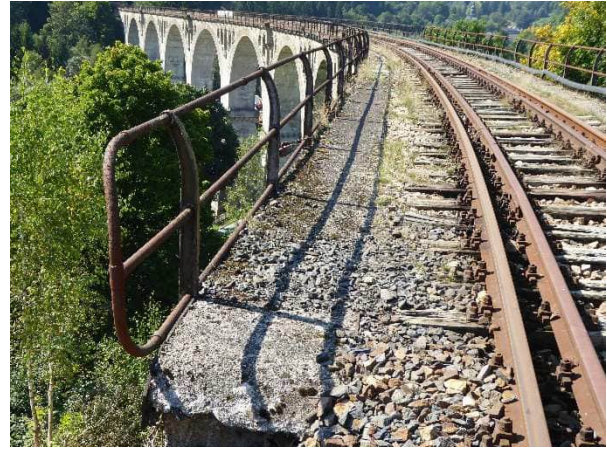
Abbildung 53 Holzschwellen, sehr unterschiedliche Zustände, Viadukt Piesau
