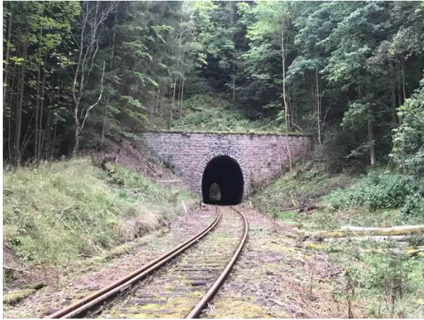
Abbildung 17 Ansicht Portal Seite Lippelsdorf
