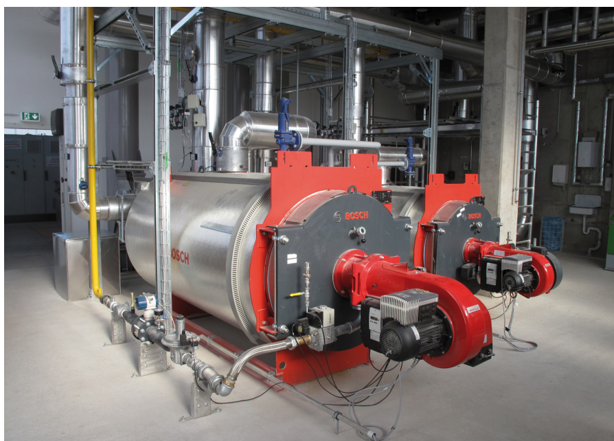
neue Gaskesselanlage im Heizhaus
