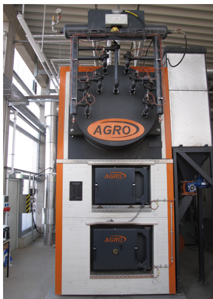
neue HHS-Kesselanlage im Heizhaus
