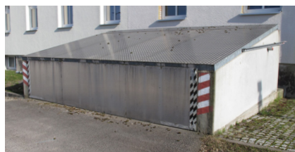
Abdeckung HHS Lagerraum mit Einfüllöffnung Haus 8
