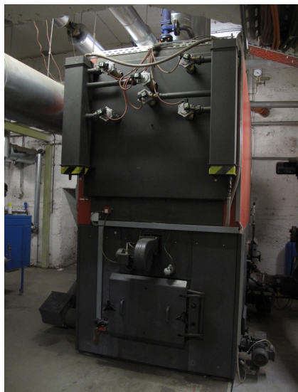
alte HHS-Kesselanlage im Haus 8
