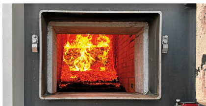
geöffnete Feuerung mit Treppenvorschubrost
